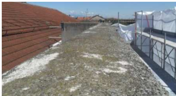
Degrado dovuto a biodeteriogeni
