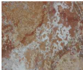
Dettaglio in macro delle effluorescenze
